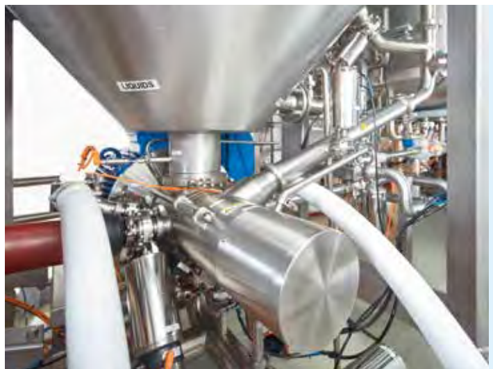
AZO LIQUIDS Homogenisator – das innovative Herzstück der Prozessanlage
